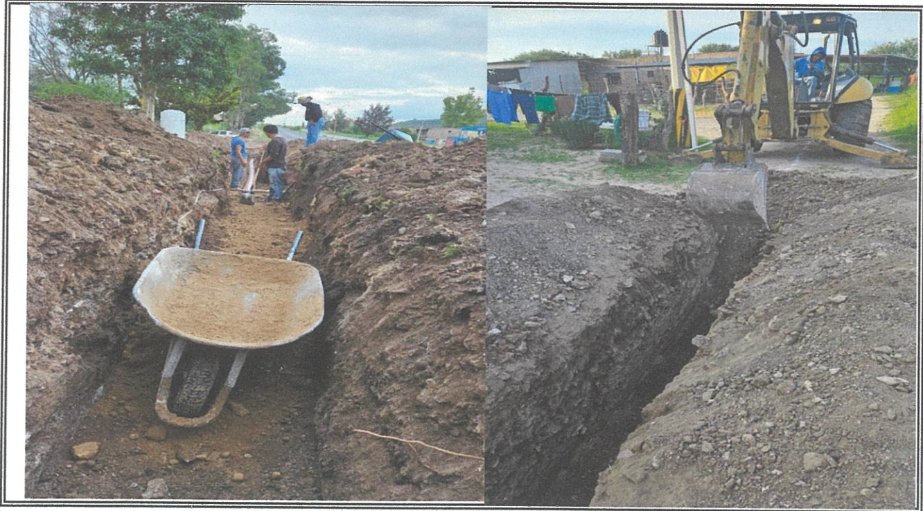
"AMPLIACION DE 954 ML. DE LINEA DE DRENAJE SANITARIO EN LA LOCALIDAD DE VELADORES, DEL MUNICIPIO DE NOCHISTLAN DE MEJIA, ZACATECAS".
