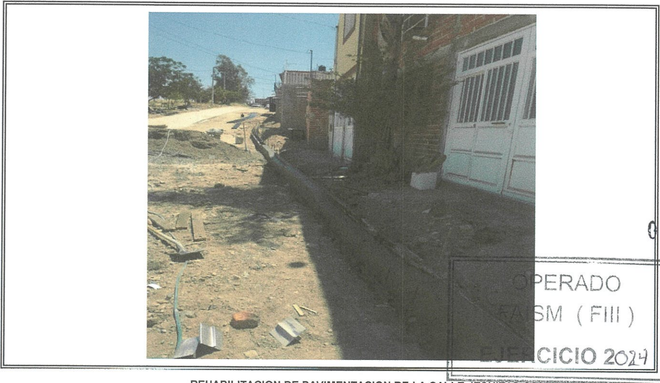
REHABILITACION DE PAVIMENTACION DE LA CALLE JESUITAS COLONIA LOMAS DEL REFUGIO DE LA LOCALIDAD DE NOCHISTLAN MUNICIPIO DE NOCHISTLAN DE MEJIA, ZACATECAS.
